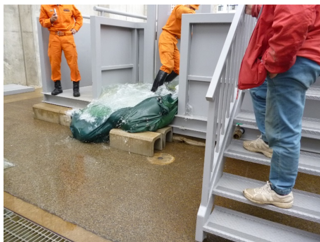
崩壊した水囊壁
